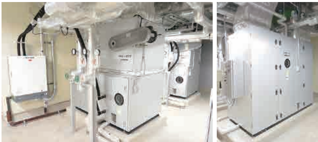
左：除湿、加湿が可能な外調機/右：潜熱一括処理の空調機
