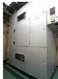
外気混合空調機
