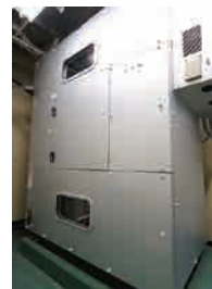
外気混合空調機
