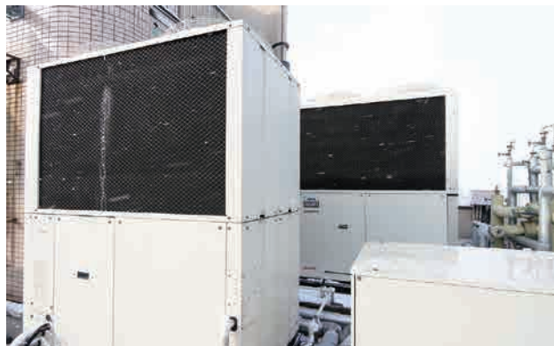
GHPチラー、GHPエアコン室外機
