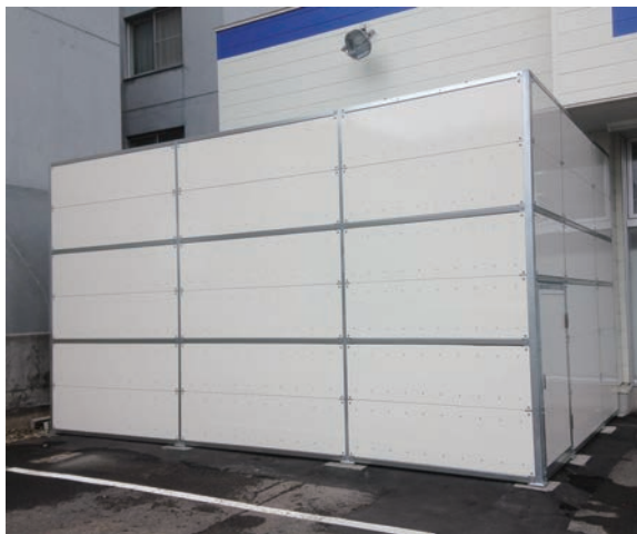
札幌市内某現場 設置写真
