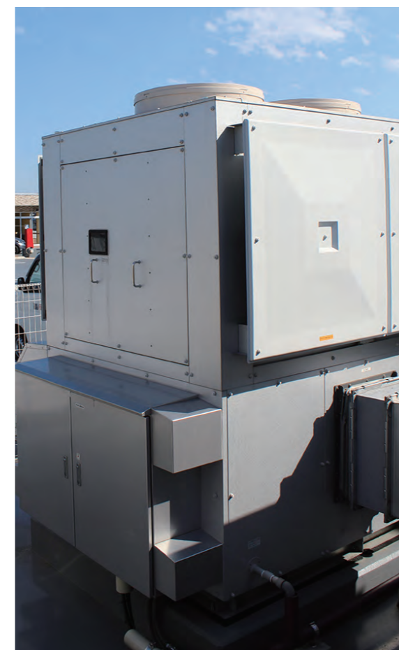
屋上駐車場に設置
