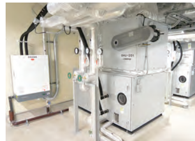
除湿、加湿が可能な外調機
