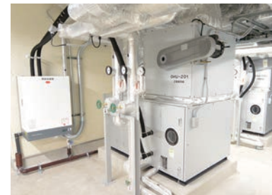
除湿、加湿が可能な外調機
