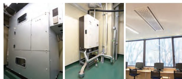
外気混合空調機
