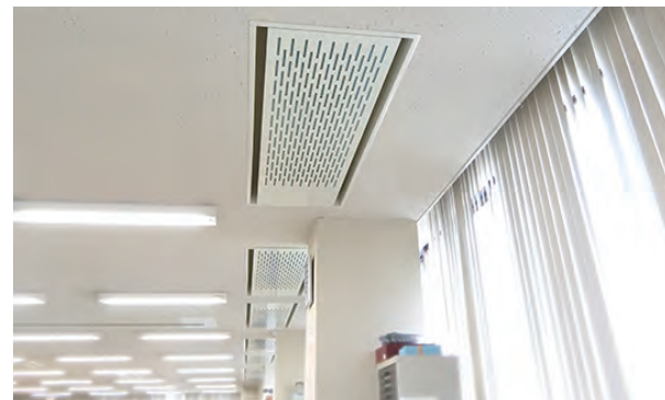
窓際に配置されたエアビーム
