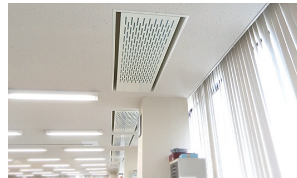
窓際に配置されたエアビーム
