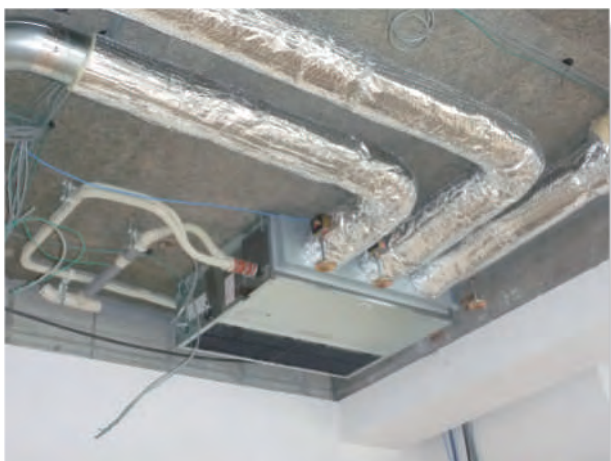
室内エアコン(市販品)設置例
