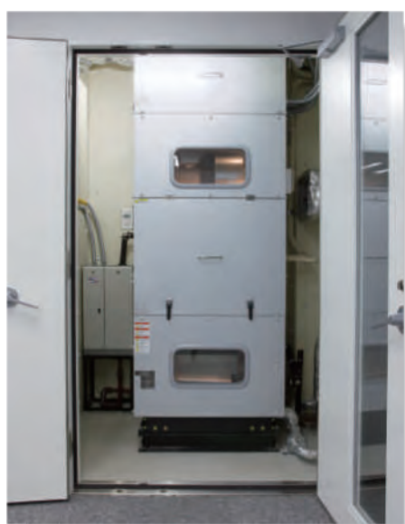
高性能外気混合空調機
