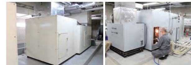
1995年納入の冷温水式エアハン 定期メンテナンス
