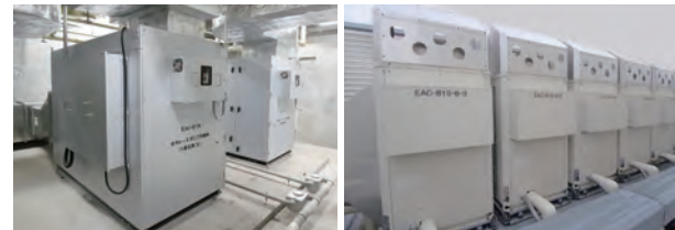
宴会場系統の外気混合空調機 寒冷地仕様室外機+防雪フード
