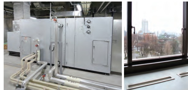
空冷式+温水式の外調機
