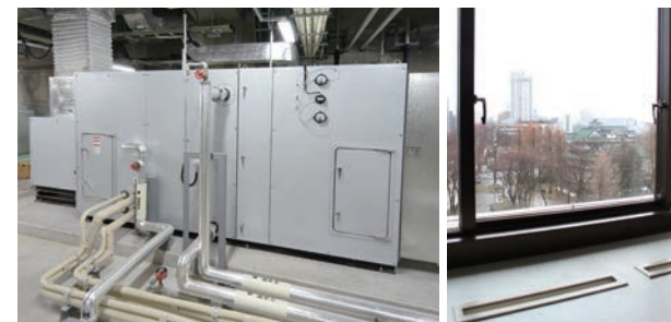
空冷式+温水式の外調機
