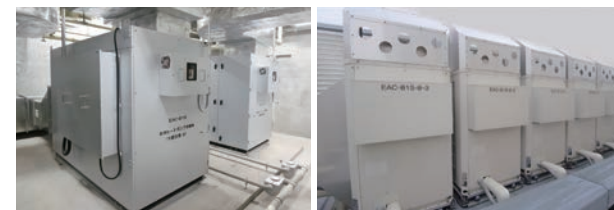
宴会場系統の外気混合空調機 寒冷地仕様室外機+防雪フード
