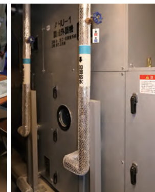
井水利用の除湿外調機
