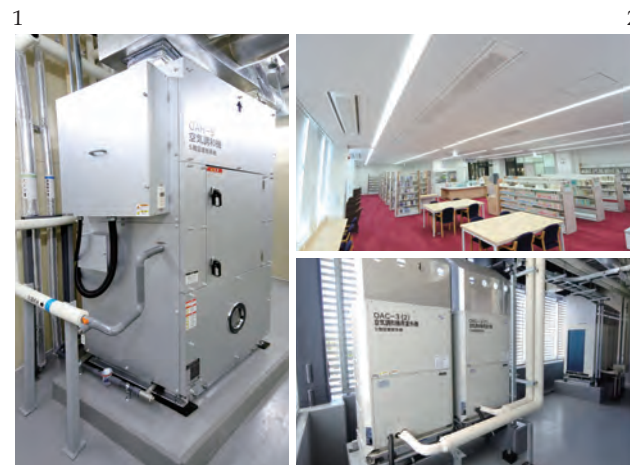
1. 空冷直膨式高性能エアハン 2. 誘引エアビームスリム形 3. KM-DX室外機(2WAY)
