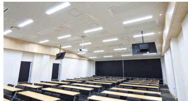
勾配天井(最高4m)に設置
