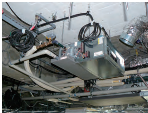
FCU(配管、PB管使用)
