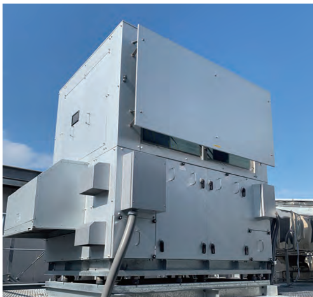
室内CO 2 を検知し、VAVにより導入外気量を制御 (外調機のインバーター制御)
