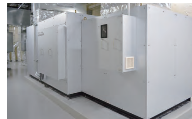
能楽堂系統 外気混合空調機
