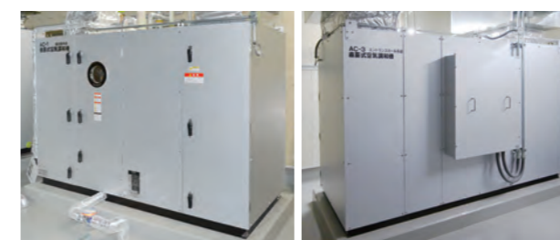
左：直会室系統 外気混合空調機(コンパクト形) 右：エントランスホール系統 外調機(コンパクト形)
