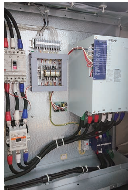
電気ヒーター制御盤
