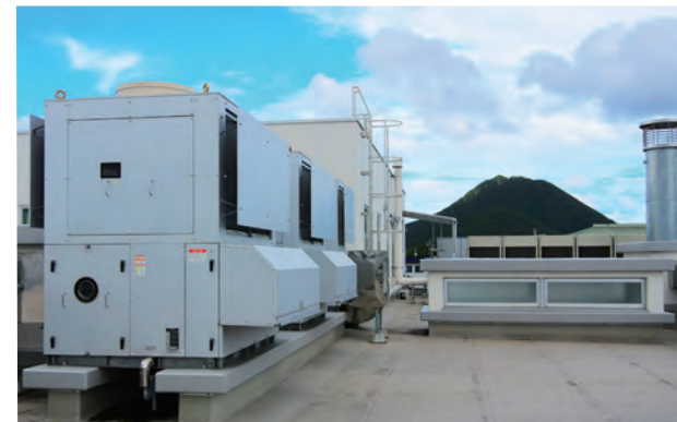
屋上に設置されたルーフトップ外調機と排気筒
