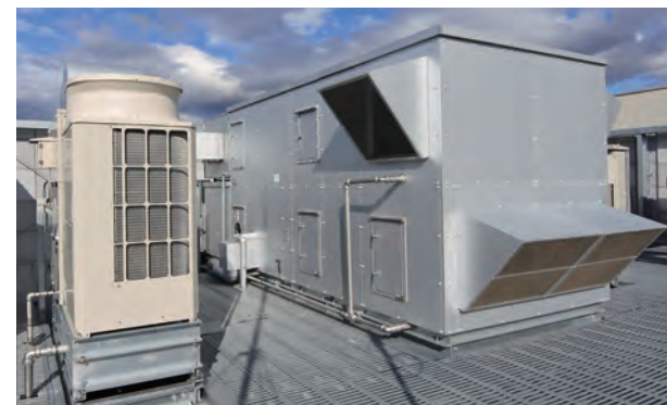
空冷直膨式エアハンと室外機
