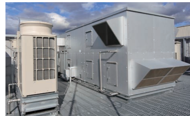
空冷直膨式エアハンと室外機
