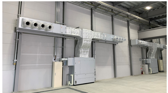
【工場用陽圧換気外調機】
