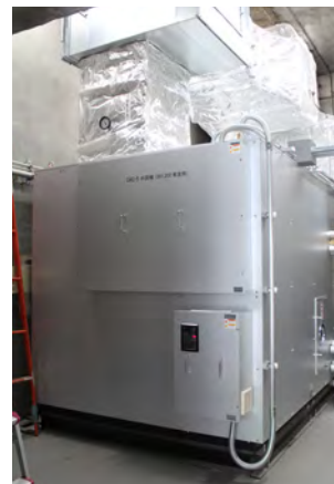
機械室内の空冷直膨式エアハン
