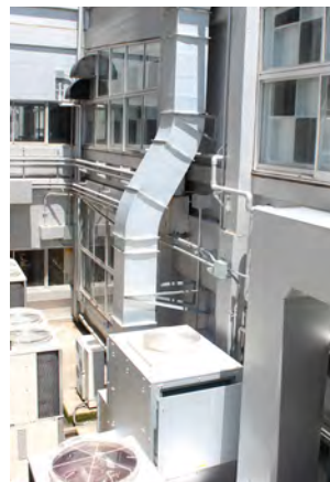
狭小スペースを活用して設置した 立形ルーフトップ外調機
