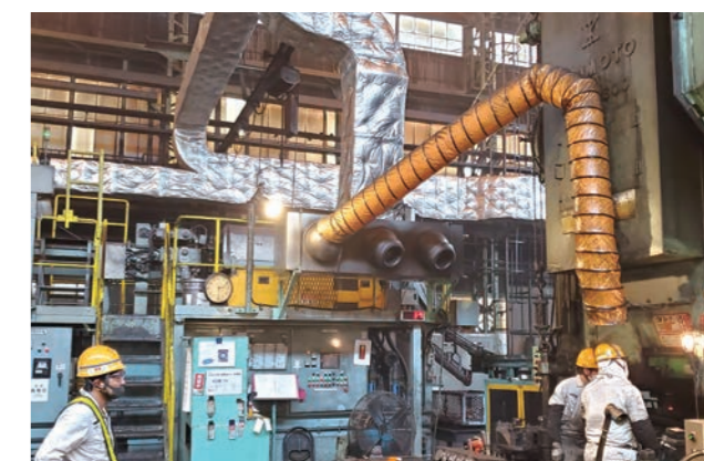
ダクトを通じて工場内の隅々まで冷風を供給
