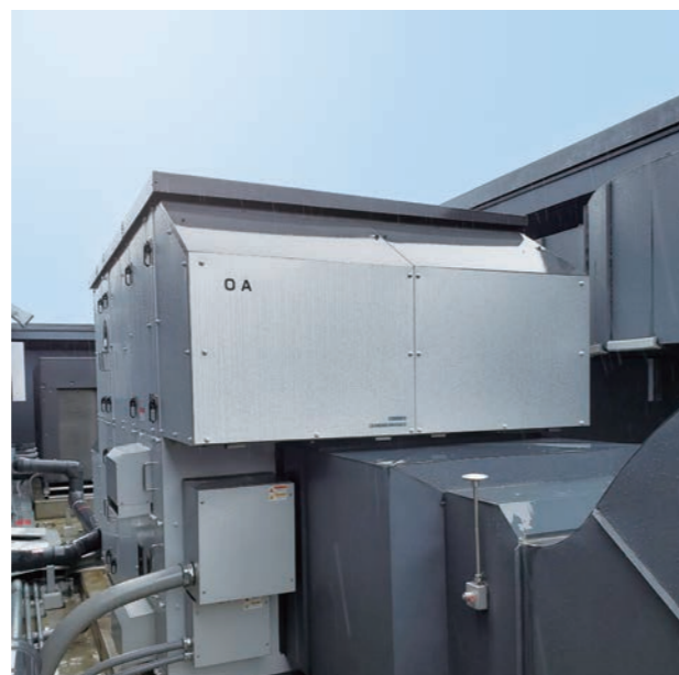
客室系統の熱回収外調機
