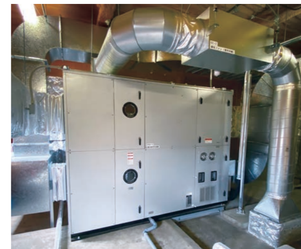
外気処理は大風量の熱回収外調機を採用
