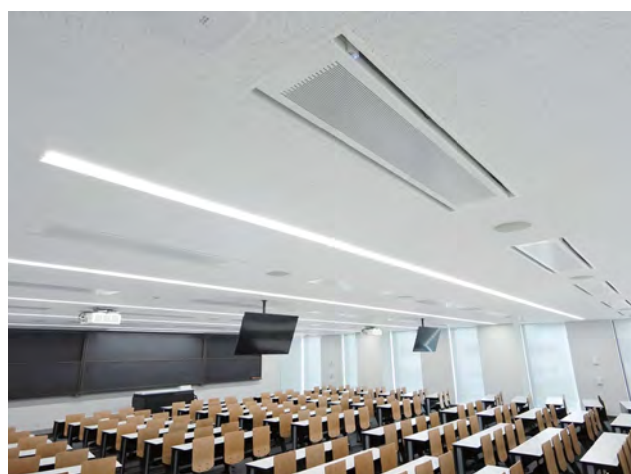
大学教室(イオン&オゾン発生器組込品)
