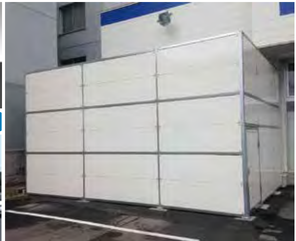
札幌市内某現場 設置写真
