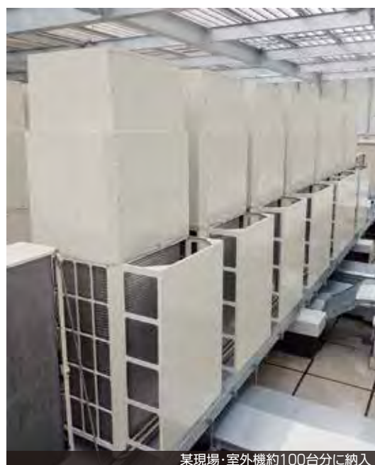
某現場・室外機約100台分に納入
