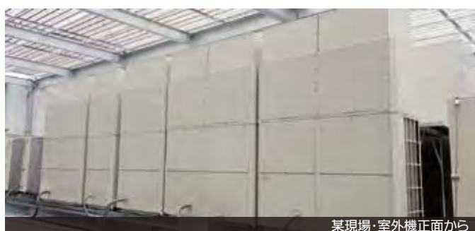
某現場・室外機正面から
