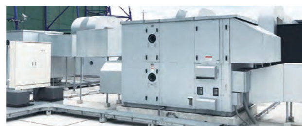
屋上設置されたBSD-12000AD型
