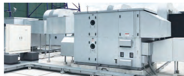
屋上設置されたBSD-12000AD型
