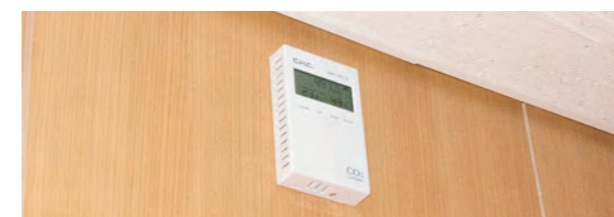
省エネ運用を可能にするCO 2 センサー
