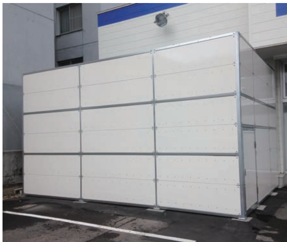
札幌市内某現場 設置写真
