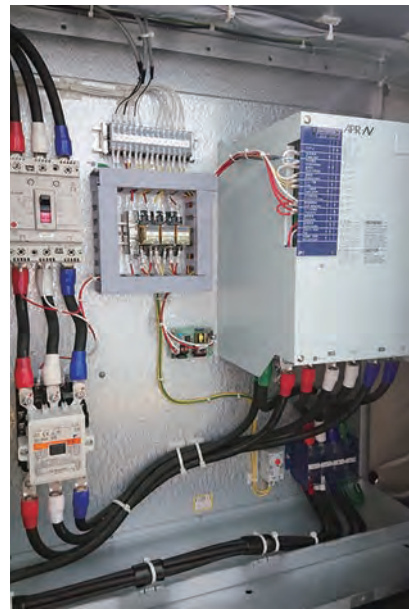
電気ヒーター制御盤
