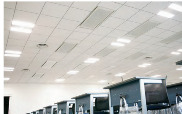
試験室の「気にならない空調」を実現する誘引エアビーム
