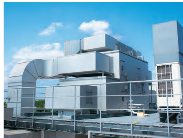
空冷直膨式エアハンAC2-ZLX-AD型と近傍設置の室外機KM-DX型
