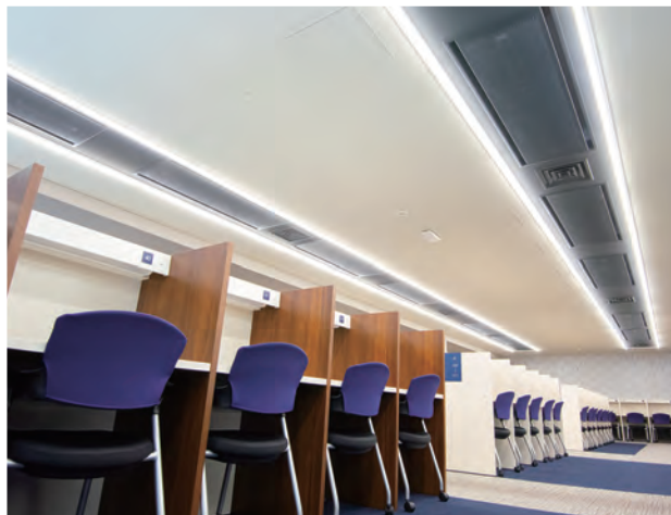
大自習室に溶け込む風を感じない空調「誘引エアビーム」
