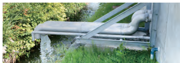
熱交換に利用され再び敷地内の下流に放出される河川水
