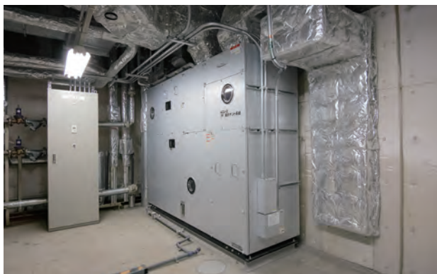
薄型コンパクト設計のARV型で改修され広々とした機械室
