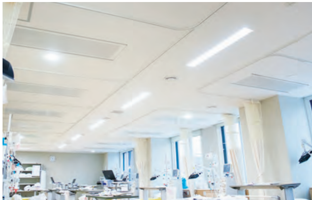
広い透析室に美しく配置された誘引エアビーム
