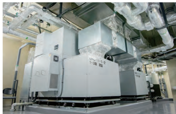
機械室内に設置され塩害対策にも有効な水冷HP式外調機
