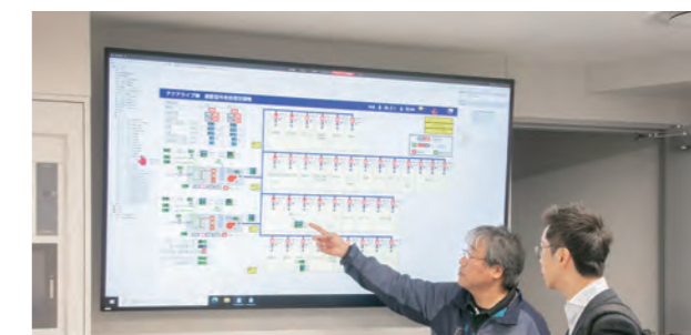
混雑度による自動制御の様子などが確認できる中央監視室
