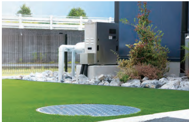
地下水を汲み上げる井戸(手前のマンホール)とポンプ制御盤(奥)
