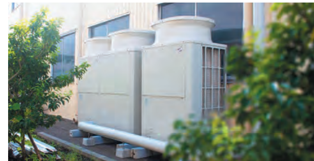
効率良く運転できるよう設置場所も考慮された室外機
