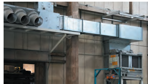
CRV2-HP型の吸込口の先に取り付けられた電気集塵機(客先施工)
