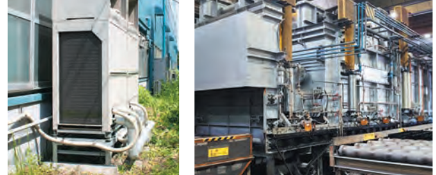
フル装備の室外機(左)と冷間鍛造に用いられる焼鈍炉(右)
