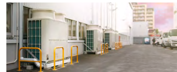
各室内機の真後ろに分散して設置された室外機
