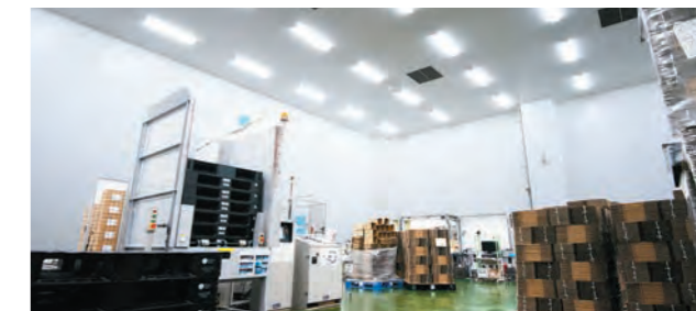
天井から室内全体に新鮮外気が供給されている包装室
