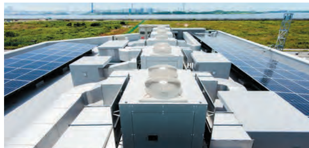
屋上に設置された太陽光パネルと省スペースなRFT型
