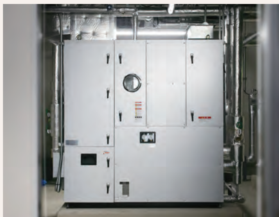
写真1 地下水熱を活用する水冷HP式外調機
