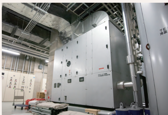
写真2 河川熱を活用する水冷HP式ハイブリッド外調機
