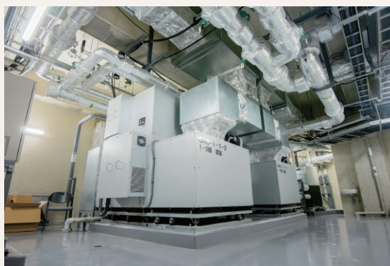
写真3 熱源水ネットワークに接続された水冷HP式外調機
