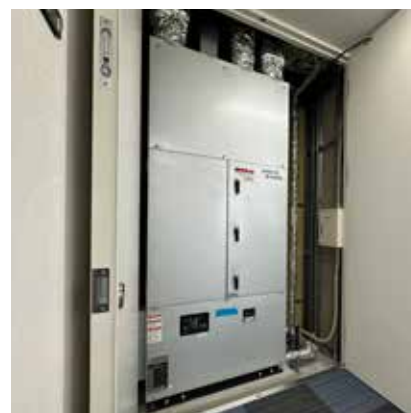
空冷HP式熱回収外調機、蒸気加湿器付 (夜間、中間期は単独運転可、省エネ)
